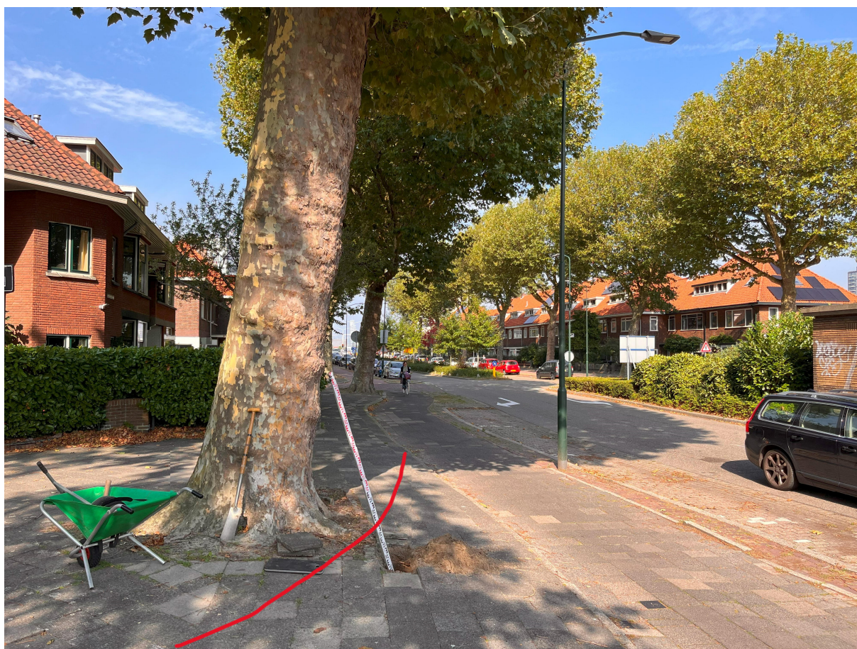
Afbeelding 3: Het afbuigen van het fietspad (in asfalt) zorgt voor ernstige wortelschade bij o.a. boom LV082. De afbuiging raakt direct grote gestelwortels welke tevens dienen als stabiliteitswortels.
